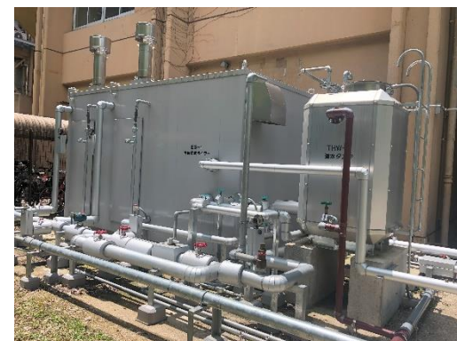
空調熱源用還流ボイラー
