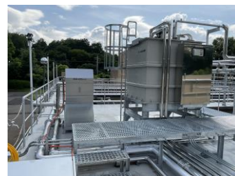
【中和処理ユニット】
