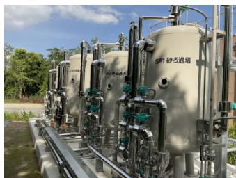
【砂ろ過槽・活性炭吸着槽】
