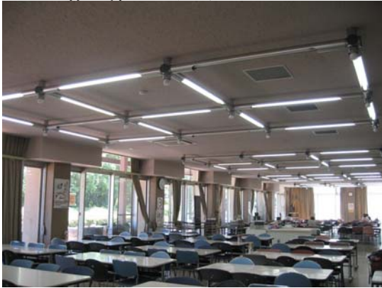
LED 化した福利棟 1F 照明器具
