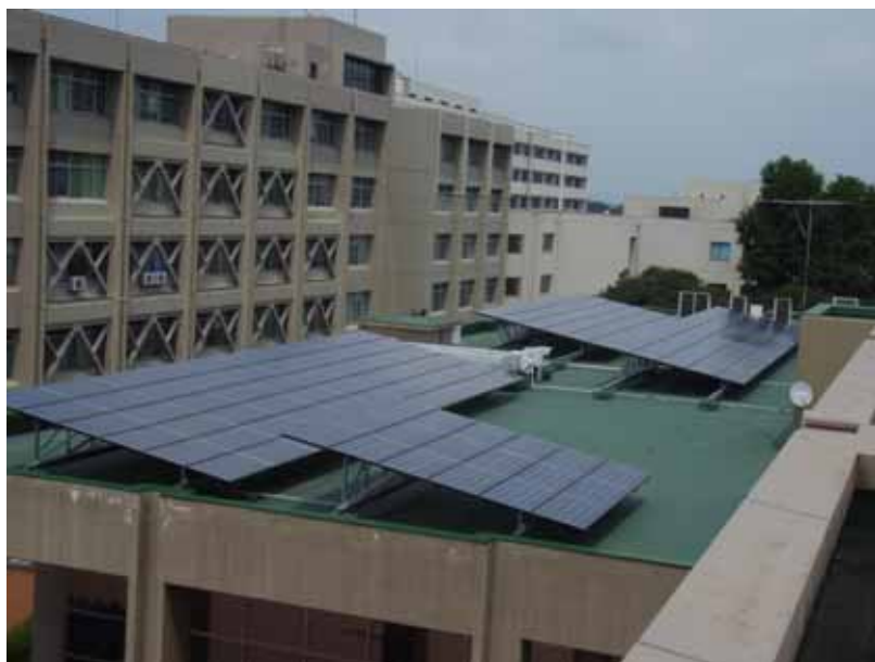
図.1 図書館屋上に設置された太陽光発電パネル
